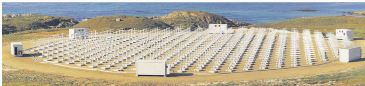
Das Leibniz-Institut für Atmosphärenphysik Kühlungsborn baut auf der nord-norwegischen Insel Andøya die modernste Radaranlage der Welt.
